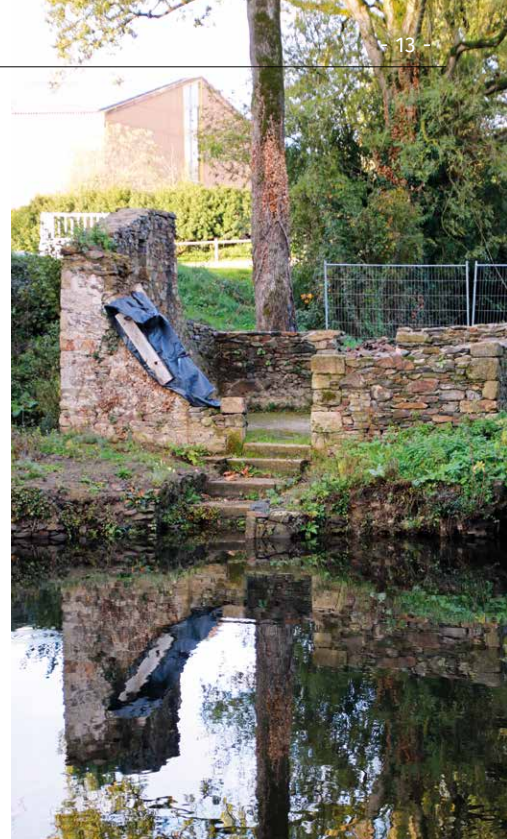
Ruines de l'ancienne buanderie, Saint-Georges-de-Montaigu
